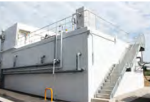
排水リサイクル設備
