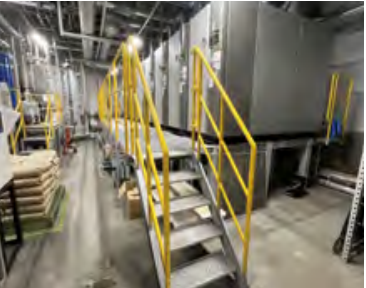
かさ上げされた羽島工場の設備
