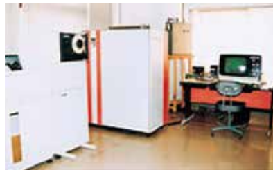
当時の電算室機械室
