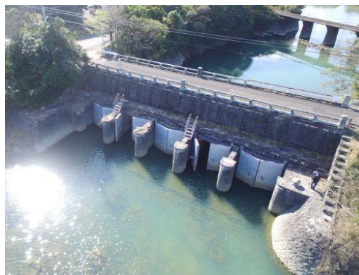
緑橋防潮水門
