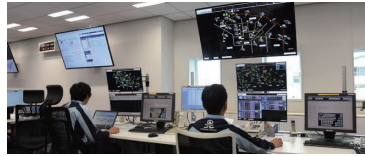
ガスの遠隔遮断
