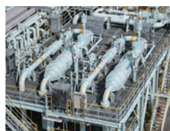
新型熱量調整設備
