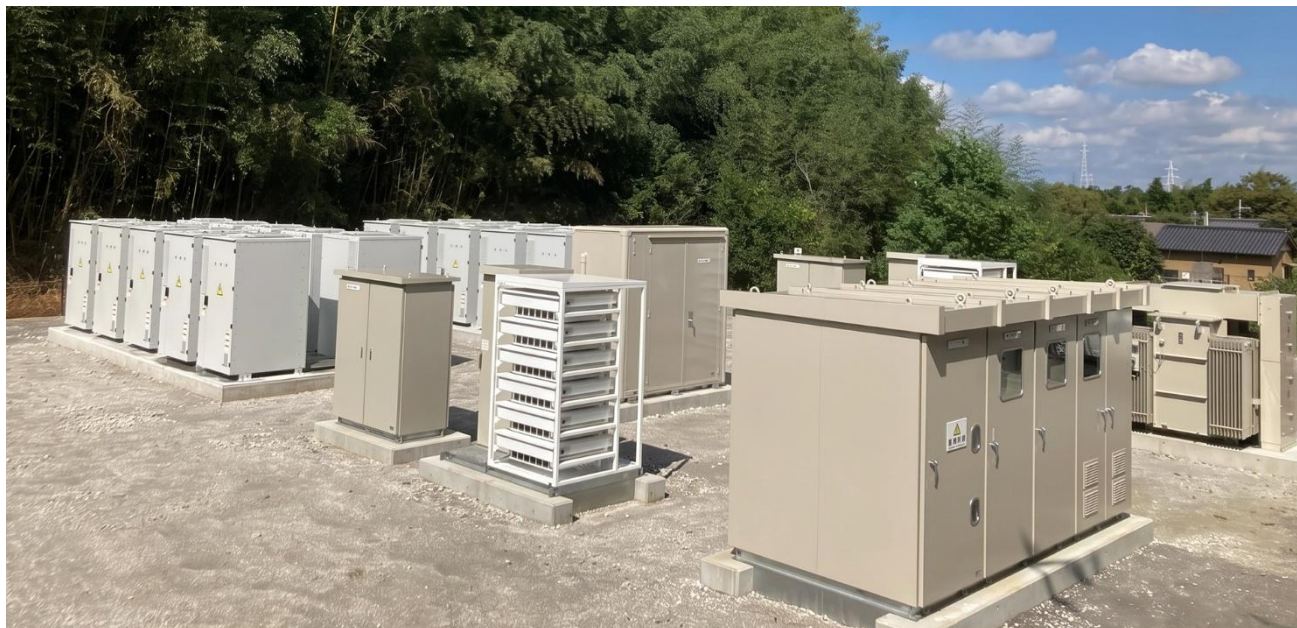
千葉県山武郡蓄電所
