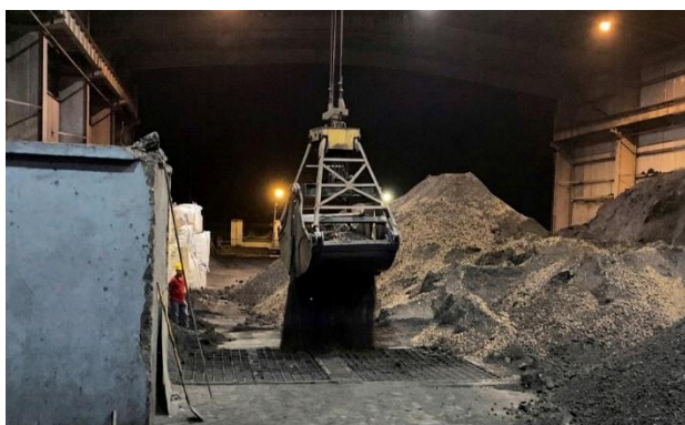
木質ペレット・石炭混合物の投入状況
