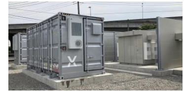
小角田蓄電所
