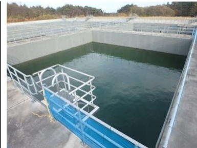
東通原子力発電所 淡水貯水槽
