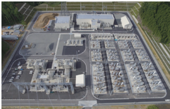
東京中部間（50・60Hz地域間）を 連系する飛驒変換所（容量90万kW）
