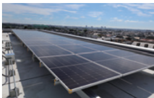
太陽光発電設備(厚木営業所)
