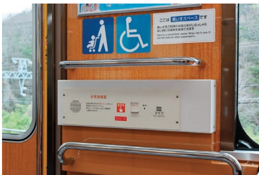
車いすスペースの非常通報装置
