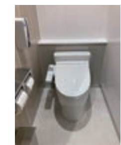
京阪神 安土町ビル 節水型トイレ
