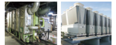
重油式の空調設備
