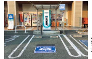
「ゆめタウン光の森」 EV充電スポット
