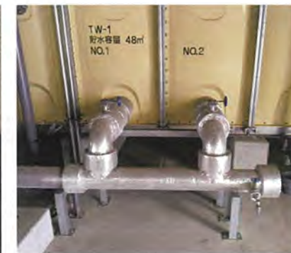
災害時給水栓
