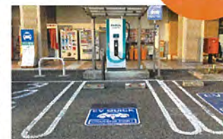
「ゆめタウン光の森」のEV充電スポット
