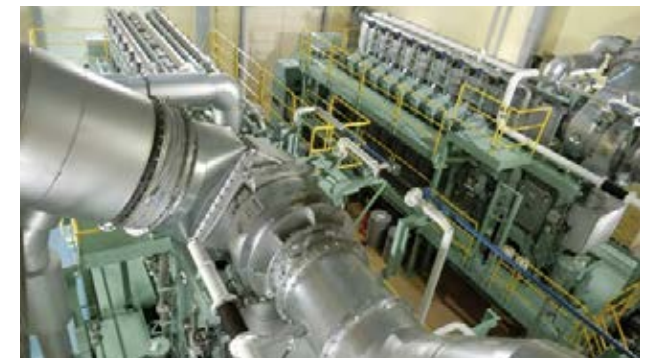
ガスエンジン発電設備
