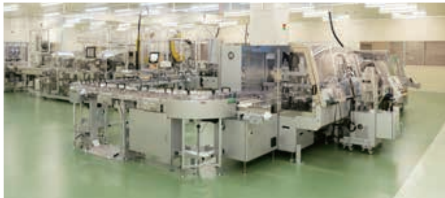
岩城製薬佐倉工場 固形剤製造設備
