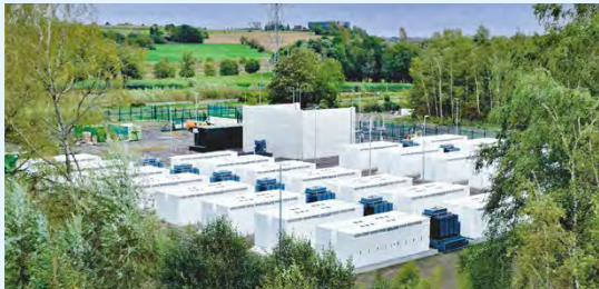
ベルギー エノー州に構える蓄電設備
