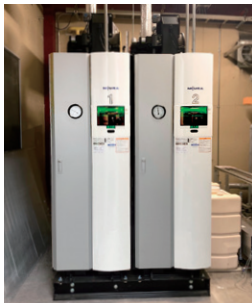
LNG用ボイラ(鹿島工場)
