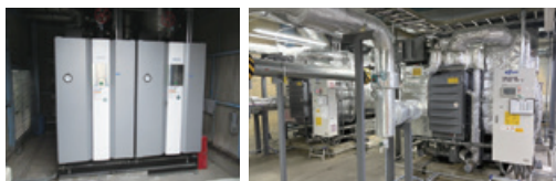
LNG用ボイラー (クレート工場)
