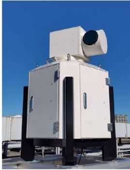
風況観測中のドップラー・ライダー (2025 年 6 月末まで当社屋上にて試験実施)
