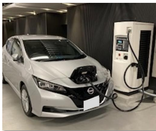
電気自動車／急速EV充電器
