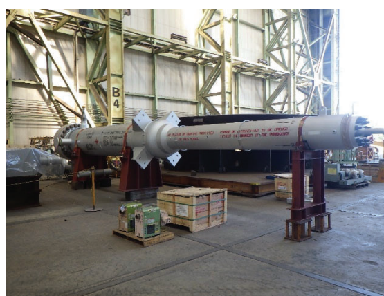
【グリーンアンモニア実証プラント用コンバーター（福島県）】
