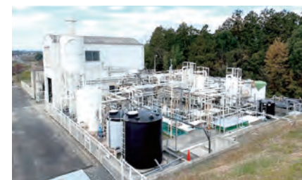
岡山工場の排水処理設備
