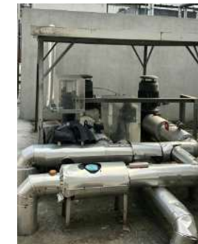
純水製造装置
