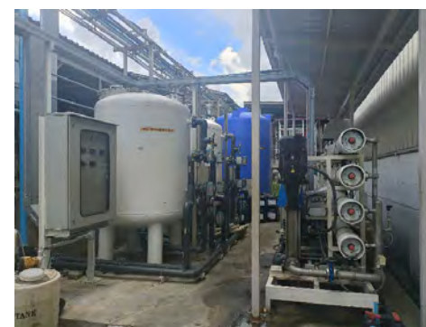
SATLの水リサイクル設備
