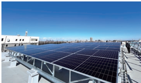
自家消費型太陽光発電設備
