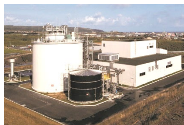
▶ バイオガスシステム
