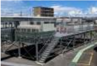
かさ上げ後の発電・空調設備
