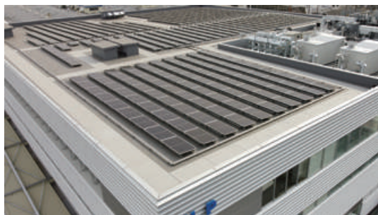
藤沢事業場 NP棟太陽光発電
