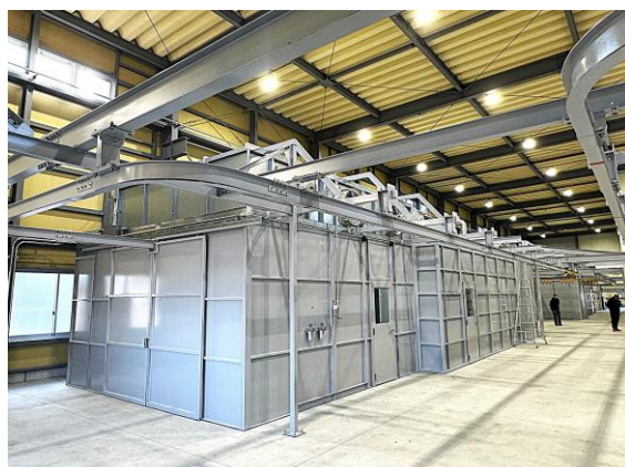
建屋 内部①（塗装設備）
