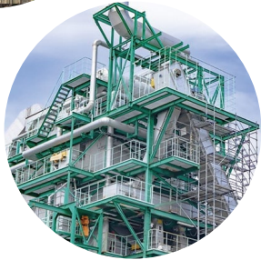
バイオマス発電施設
