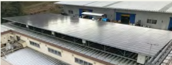
菰野町本社屋上の太陽光パネル(2007年～)
