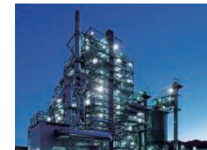
バイオマス発電設備
