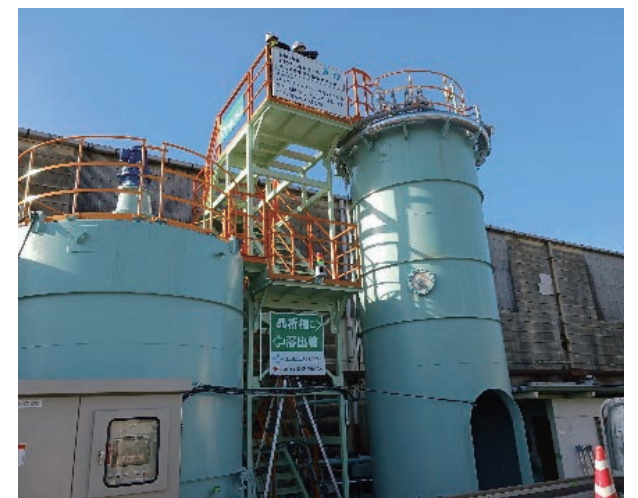
滋賀工場に建設したパイロットプラント
