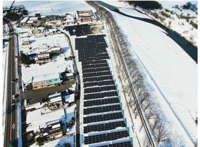
滋賀高月事業場の敷地外に新たに設置した太陽光発電設備
