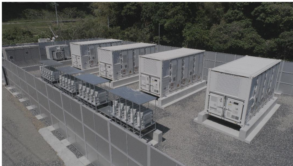
系統用蓄電所（※写真：株式会社パディネット 提供）
