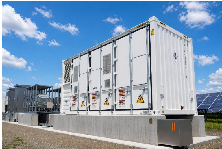
大塚グループの工場敷地内に設置された蓄電池システム
