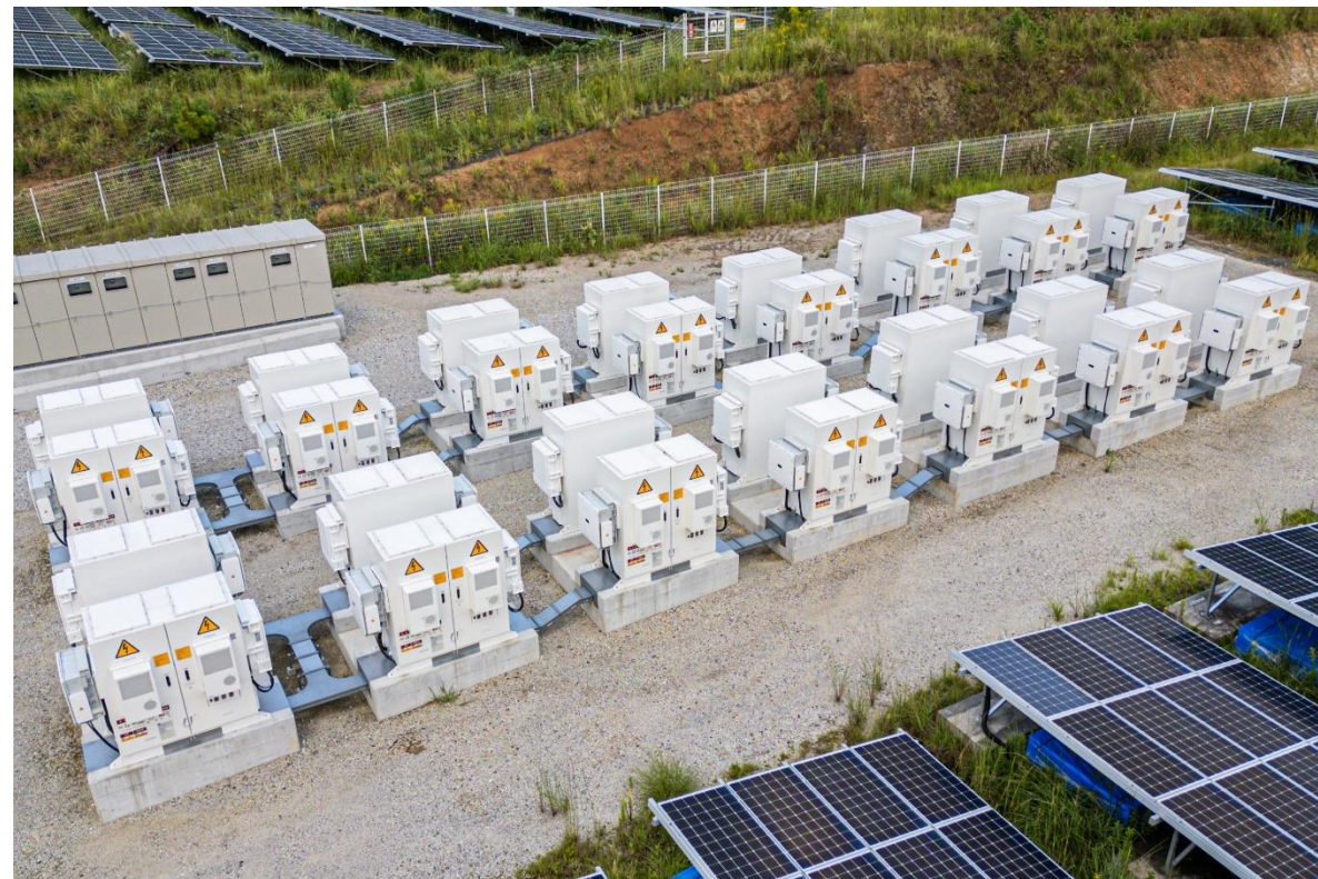
太陽光発電所に併設された蓄電池
