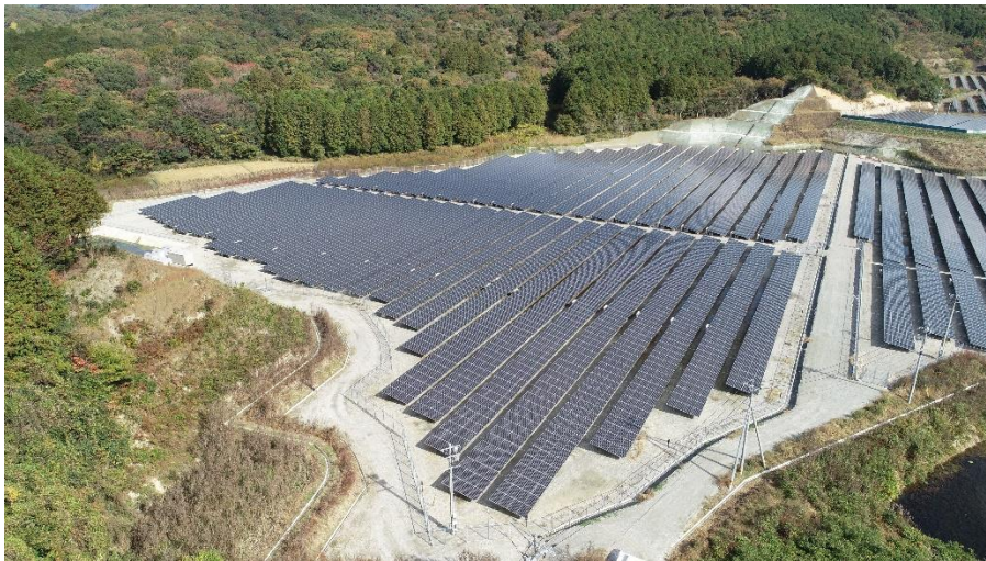
蓄電池を併設する太陽光発電所「福岡・飯塚第一メガソーラー発電所」（所在地：福岡県飯塚市）
