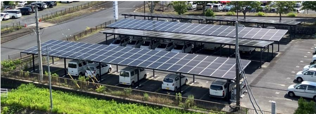
伊賀市役所本庁舎に設置した自家消費型太陽光発電システム（カーポート型）
