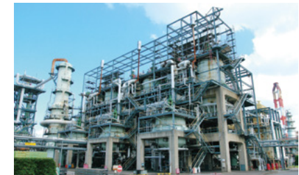
富士石油(株)の減圧残油熱分解装置(ユリカ装置)
