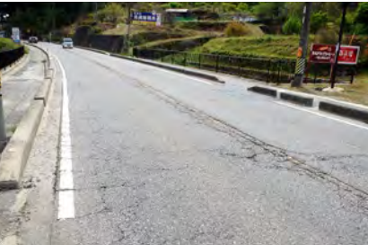
破損が進行した既設舗装
