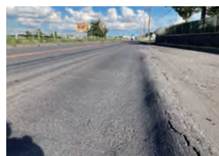
舗装のわだち掘れ
