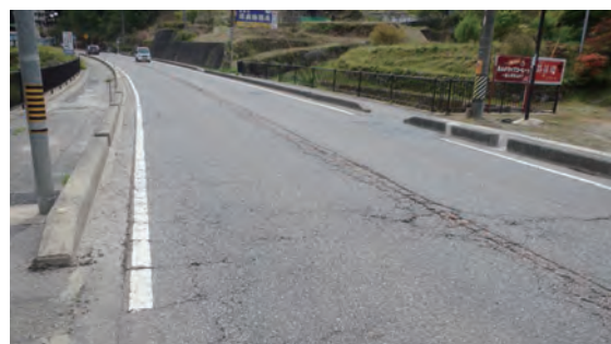
破損が進行した既設舗装
