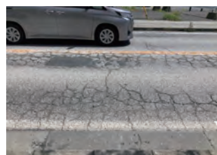
舗装のひび割れ
