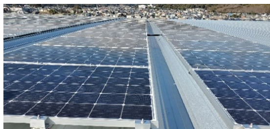
屋上に設置した太陽光パネル
