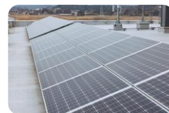
太陽光発電所
