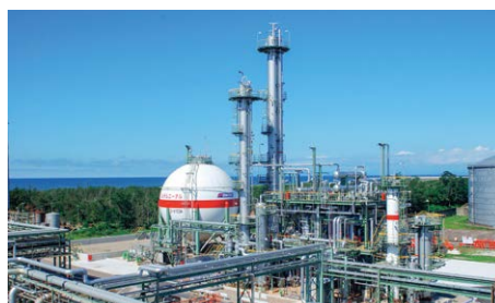
DMEプラント(新潟工場)
