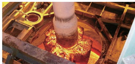
製鉄向け機械攪拌式脱硫設備
