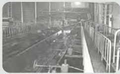
苫小牧工場の新聞古紙脱墨設備
