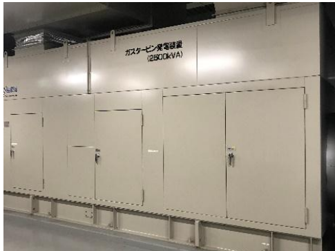
非常用発電施設
