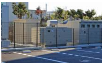
非常用発電機
